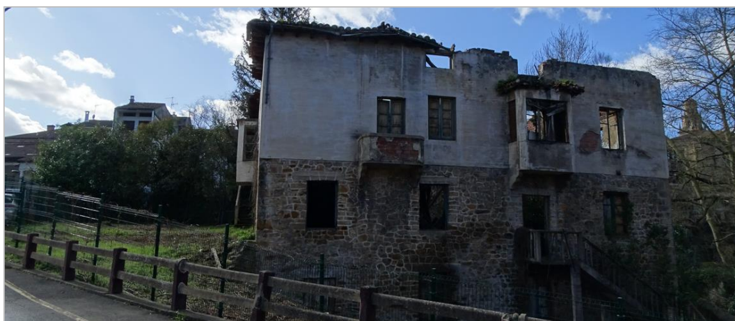
Foto 25. Edificio ruinoso en el EL-05 Azpikoerrotza
